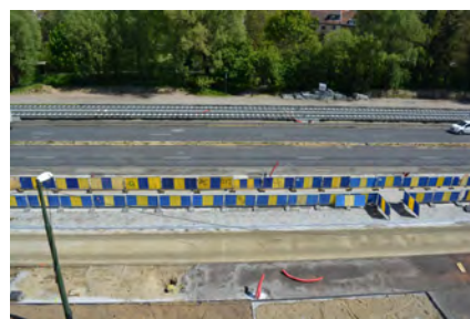
Aperçu d'une phase en cours d'exécution, à partir du troisième étage du bâtiment du CRR à Woluwe
